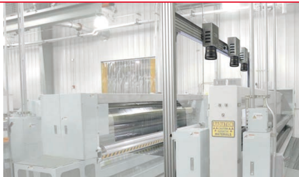
Estrusione di film di PET con sistema di controllo ottico della qualità (fonte: OCS GmbH)
